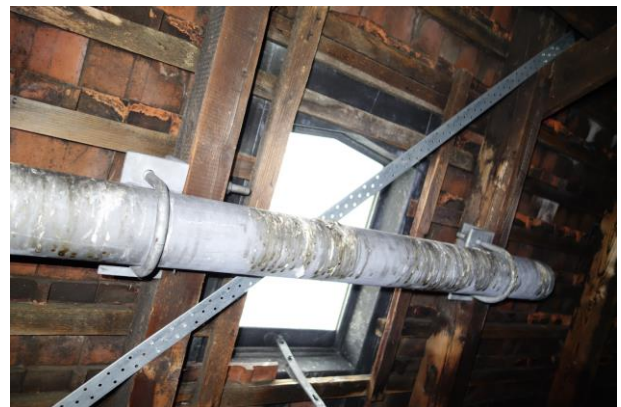
Abbildung 24: Die Dachfenster sind geschlossen. Eine Einflugmöglichkeit für Fledermäuse ist nicht gegeben.
