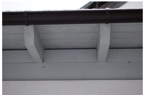
Abbildung 26: Der Spalt zwischen den Holzleisten und Außenmauer ist schmal und wenig tief. Als Quartier für Fledermäuse ungeeignet.
