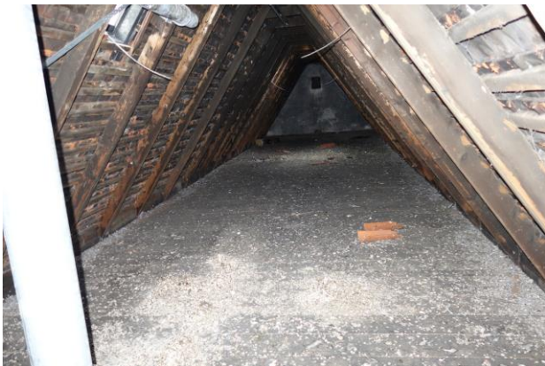
Abbildung 21: Dachboden mit viel Taubenkot.
